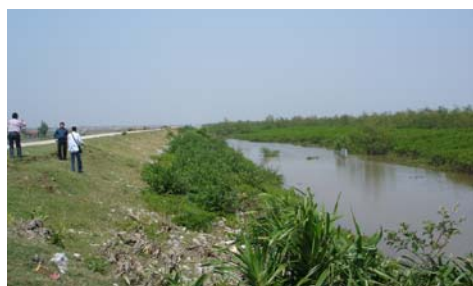
5km đê có rừng ngập mặn ở xã Thái Đô được bảo vệ hoàn toàn không bị sóng, bão số 7 làm xói lở (Ảnh: Phan Hồng Anh, 10/10/2005)
