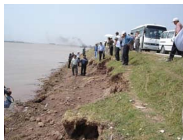
650m đê quốc gia ở xã Thái Đô - Thái Thụy - Thái Bình bị xói lở trong cơn bão số 7 vì không có RNM bảo vệ (Ảnh: Phan Hồng Anh, 10/10/2005)
